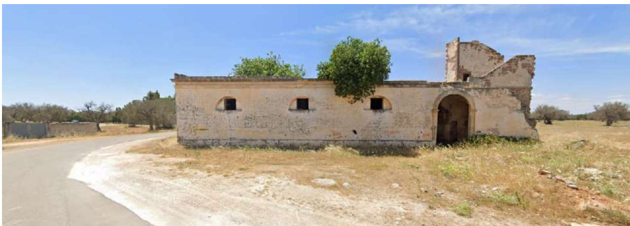
La Masseria Gustapane, in stato di abbandono e avanzato degrado strutturale
